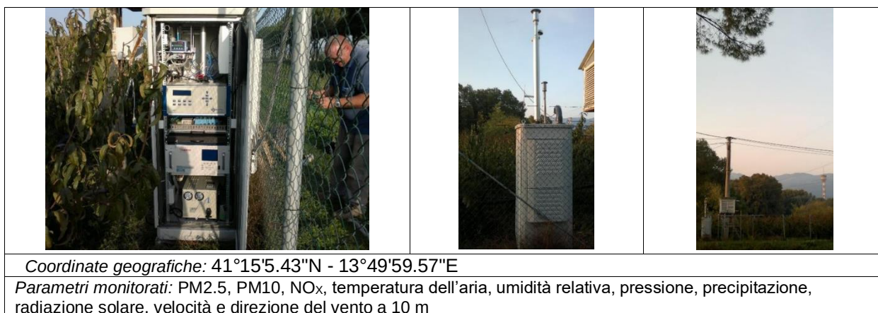
Figura 4.1 Cabina di monitoraggio
