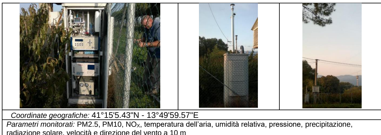
Figura 4.1 Cabina di monitoraggio
